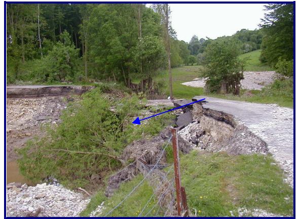
Cette voie communale à également été emportée malgré un ponceau en brique conséquent sous chaussée (DIREN mai 2000)
