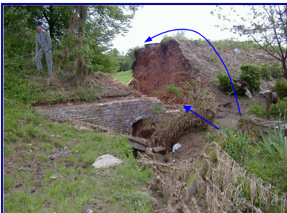
Rue d'Ybouville effondrée, on distingue encore le ponceau en brique. Le niveau de surverse atteignait environ 50 cm au dessus de la chaussée.
