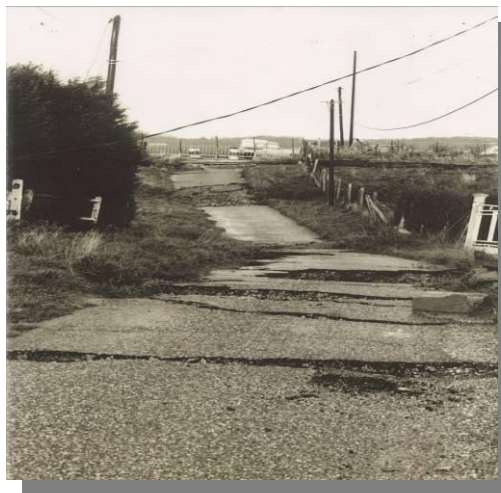
figure 5 : effondrement généralisé, commune de Vitot (27)
