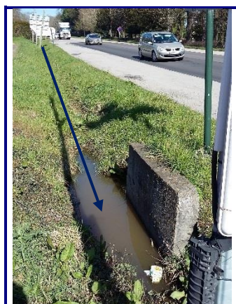
Eau stagnante dans le fossé, canalisation bouchée
