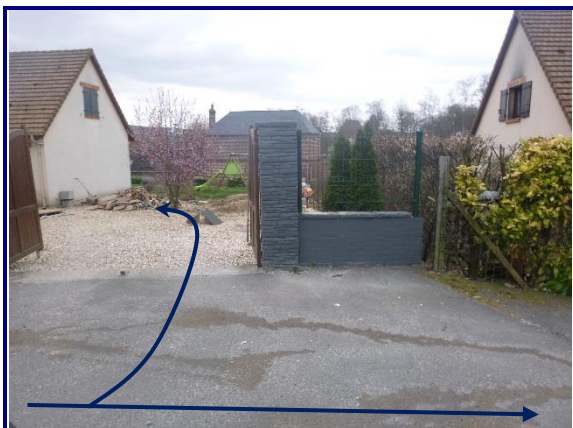
Sous-sol régulièrement inondé. Il est à noter que le riverain a récemment bouché sa descente de sous-sol.
