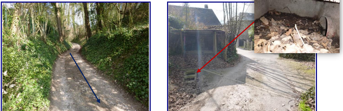
Apport d'eaux chargées de limons provenant de la cavée. Un encombrement important est observée sur la tête de réseau Ø300mm.
