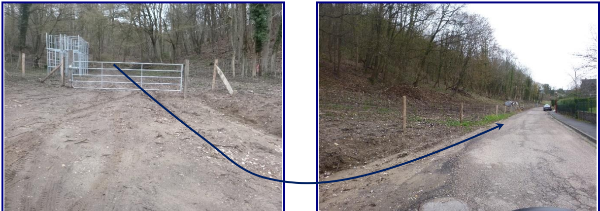
Apport d'eaux chargées de limons provenant de la cavée du May, récemment réaménagée. Un atterrissement est observé sur la voirie et dans les réseaux de canalisation de la rue
