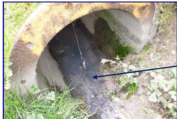
Rejet d'eaux usées dans le fossé en amont des habitations
