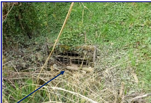
Déchets créant un embâcle en entrée de buse
