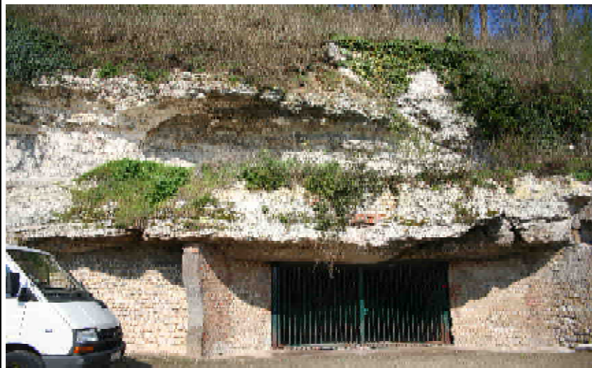
Petit panneau de craie délimité par des fractures arrières potentiellement instable
