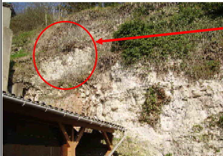
Secteur de la falaise fortement altéré protégé par un grillage plaqué
