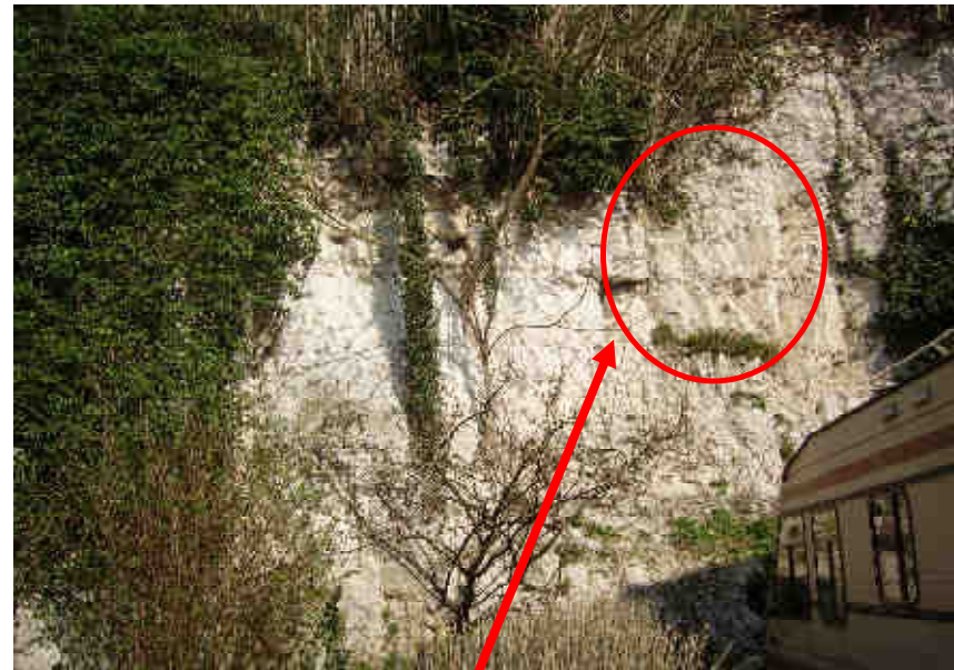
Blocs ou panneaux en surplomb potentiellement instable
