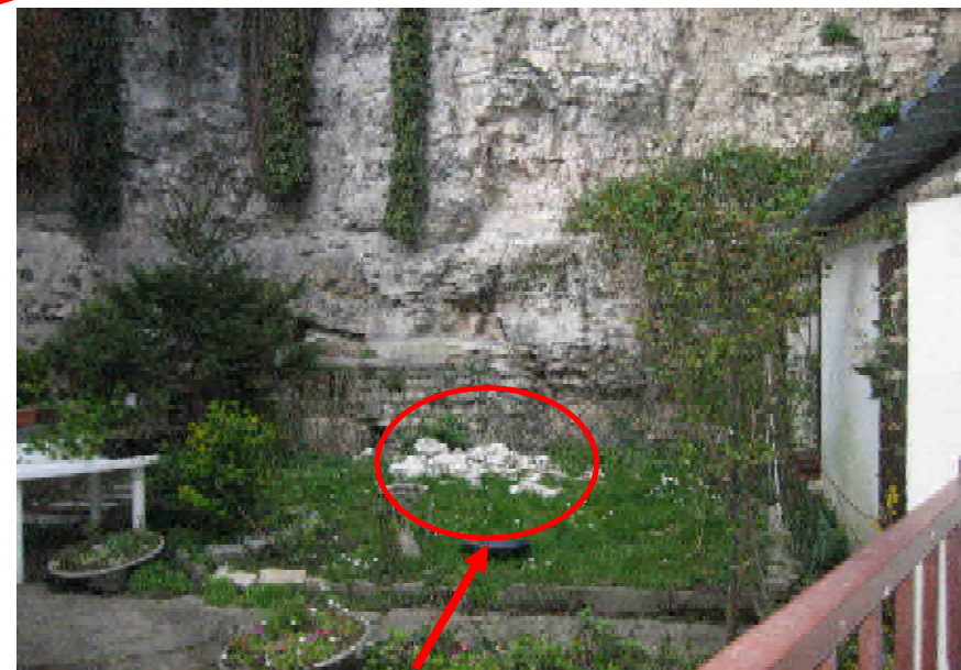
Chutes de blocs en pied de falaise
