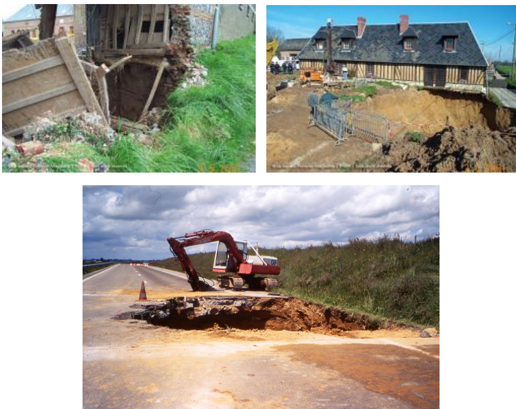
Photographie n° 4 : Exemples de dangers liés aux cavités
