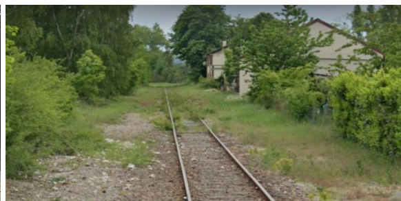
Petit Couronne : une voie dans un état très dégradé.
