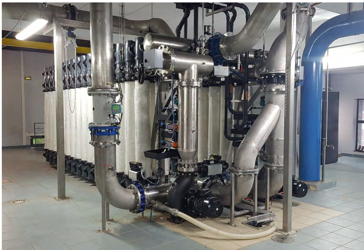
Unité d'ultrafiltration – Usine de la Jatte ROUEN
