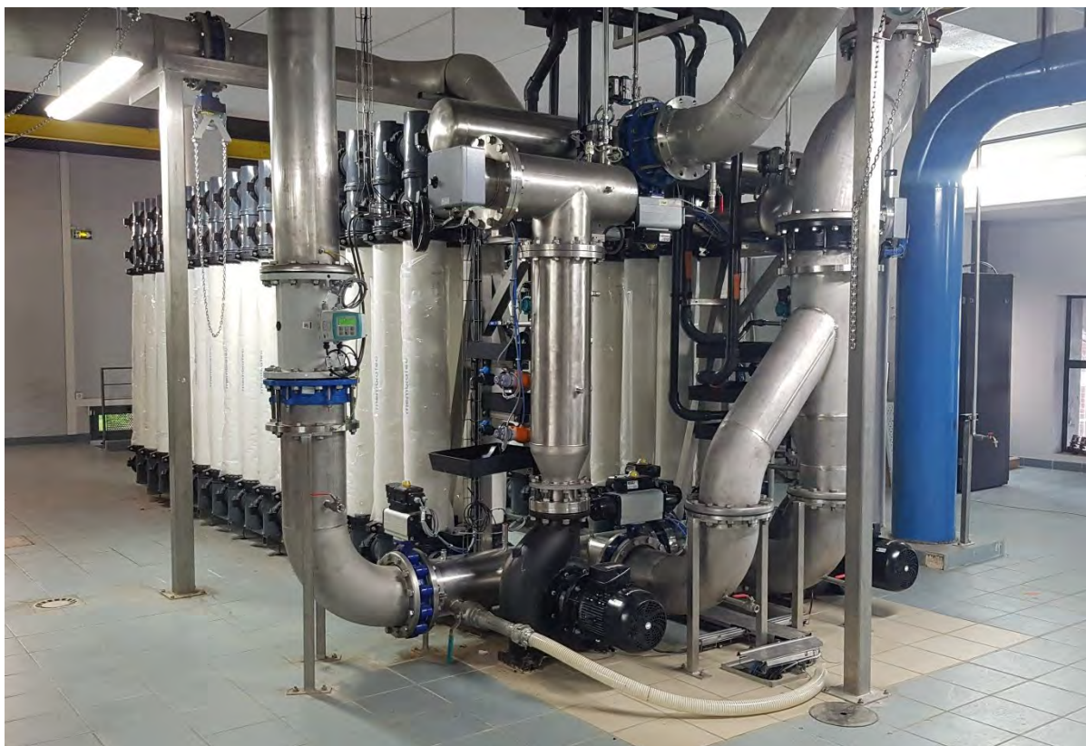
Unité d'ultrafiltration – Usine de la Jatte ROUEN
