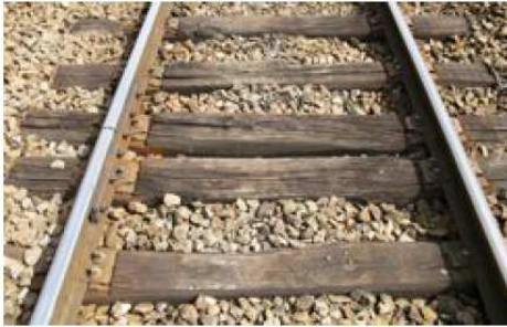
illustration 19 : rails courts sur traverses bois
